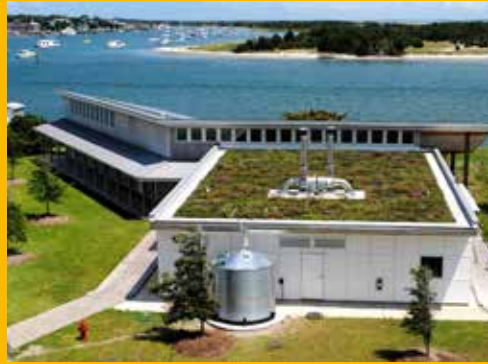
Cubierta Jardín en Universidad de Duke, Centro de Conservación de los Océanos (Beaufort, Carolina del Norte, EE.UU.) Sistema Sika Green Roof - Año: 2010. Área: 710m 2 - Pendiente: 1%.
